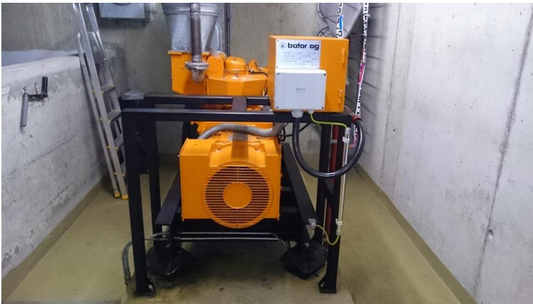
Abb. 2 Notstromaggregat in Oberbuchsiten mit neuen Dämpfern
